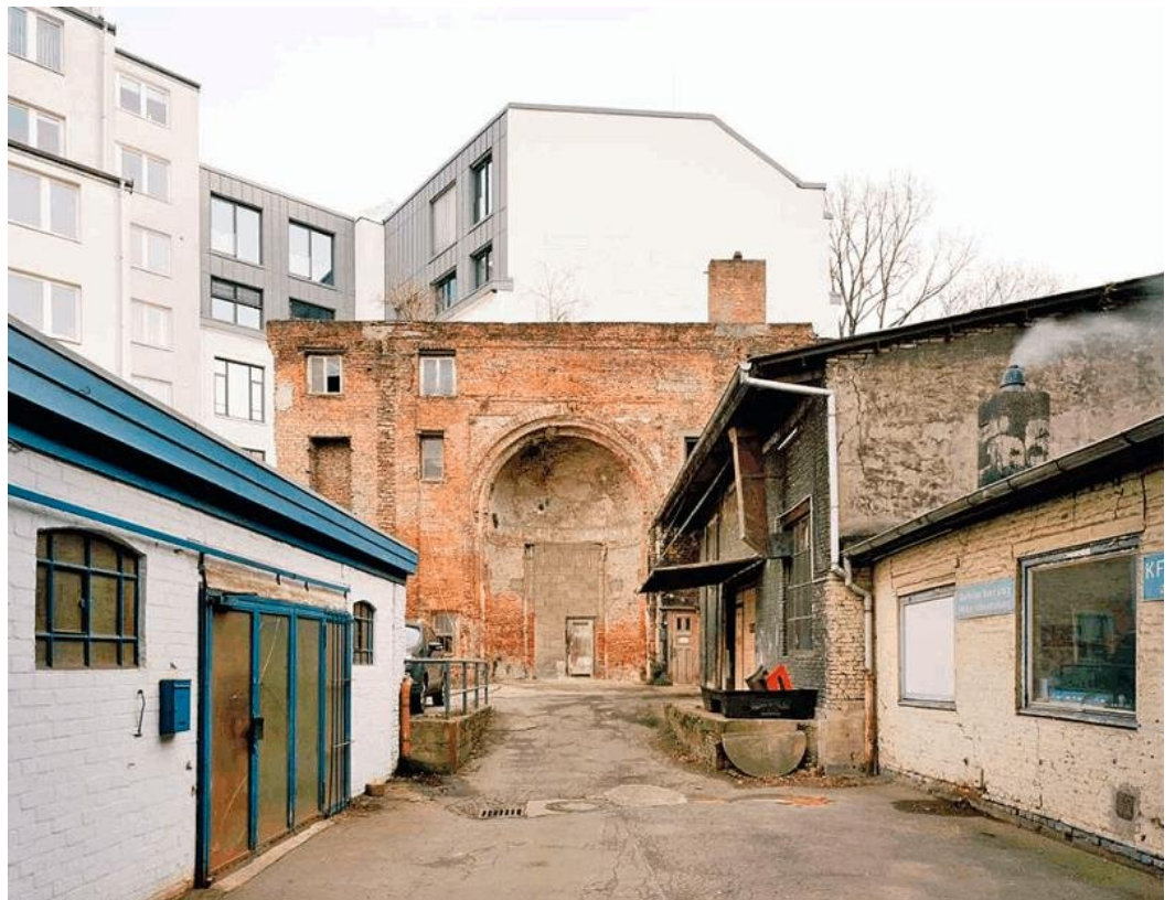
Die Reste der Synagoge in einem Hinterhof an der Hamburger Poolstraße – vom Verfall bedroht.
